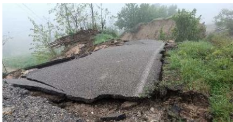
Un tratto di strada distrutto sul passo del Monte Trebbio (Frasca)
